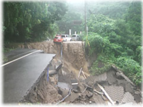
道路が決壊され、落下寸前の車両
