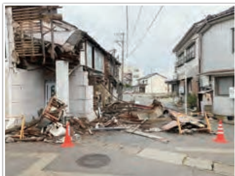
倒壊した家屋
