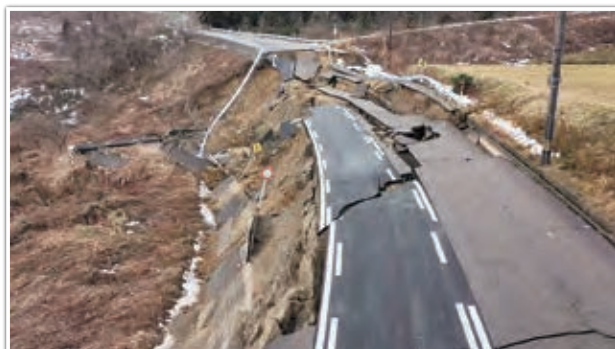
崩落した道路
