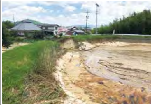
写真1 平成30年7月豪雨によるため池の決壊
