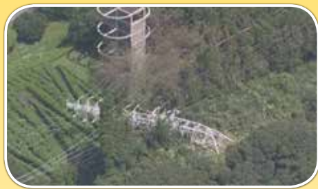
千葉県君津市での倒壊した送電鉄塔
